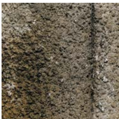
Paredes sucias, enmohecidas o húmedas
